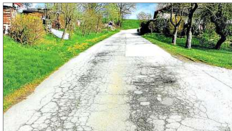
Bald keine Gefahr mehr für Radfahrer soll die Ortsdurchfahrt Raßbach sein. Der Gemeinderat hat beschlossen, Risse und Schlaglöcher durch Flickasphaltierung zu beheben.
