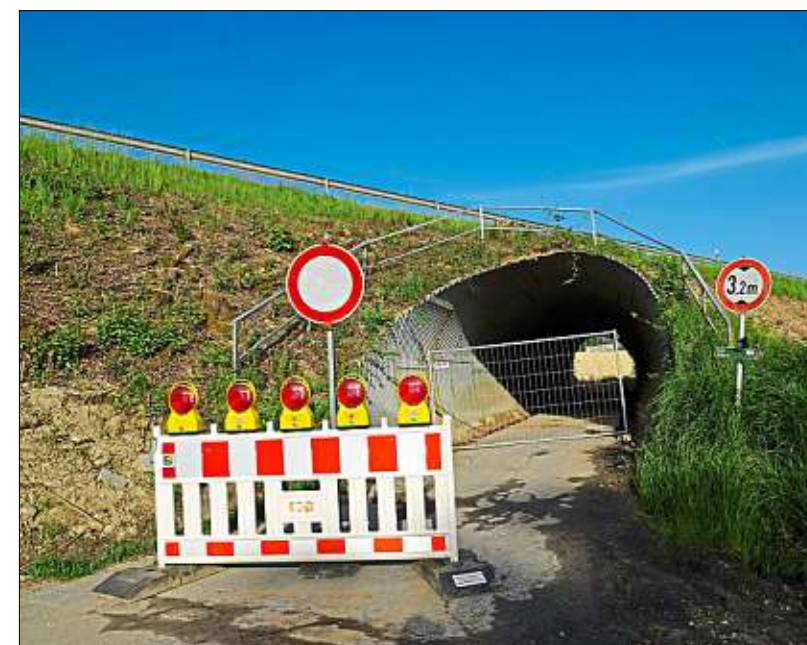
Das Bauwerk unter der B 12 besteht aus einem Wellstahlprofil von 1977 und weist erhebliche Schädigungen auf. Es wird durch einen offenen Stahlbetonrahmen ersetzt.
